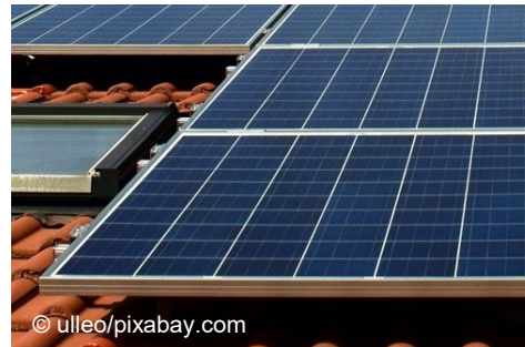
Solarmodul mit 60 polykristallinen Solarzellen
